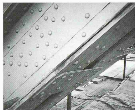
14 Aufweitung infolge Tiefenrost bei zusammen-genieteten Lamellen
