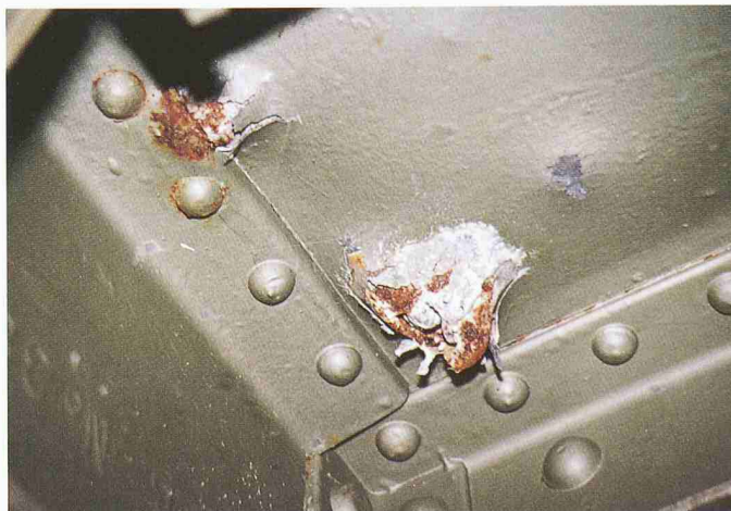
Buckelblechbeschädigung bei Betonabbruch 1970: Jetzt Durchgangsöffnung für in die Betonplatte eingedrungenes Wasser
