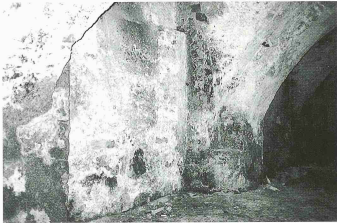
Pfalkeller vor der Mauerentfeuchtung/-sanierung: Seitlich eindringende Nässe, aufsteigende Mauerfeuchtigkeit, Verfleckungen und Abstossungen, sowie biologische Schadstoffe und Ausblühungen
