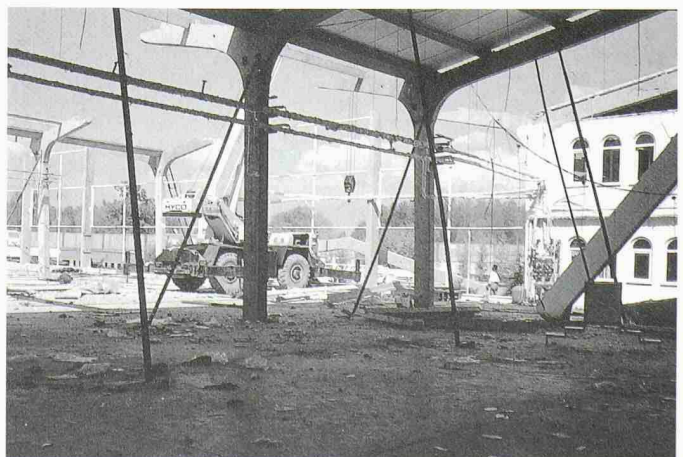
13 Die Querrahmen der vorfabrizierten Konstruktion scheinen weitgehend intakt. Sämtliche Rahmenseile sind jedoch im untersten Drittel durch einen Schub-/Biegebruch irreparabel beschädigt
