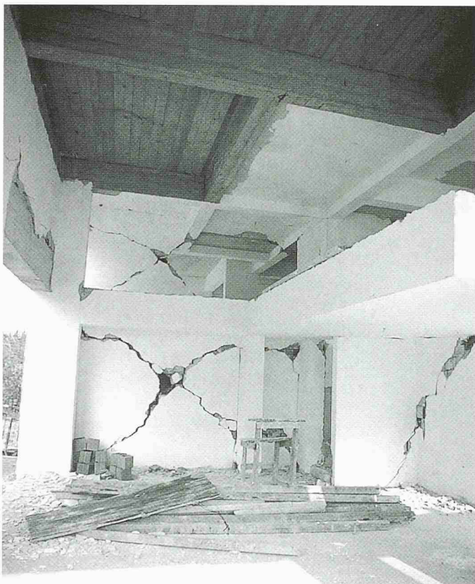
3 Kreuzrisse in einer nichttragenden Mauerwerkswand
