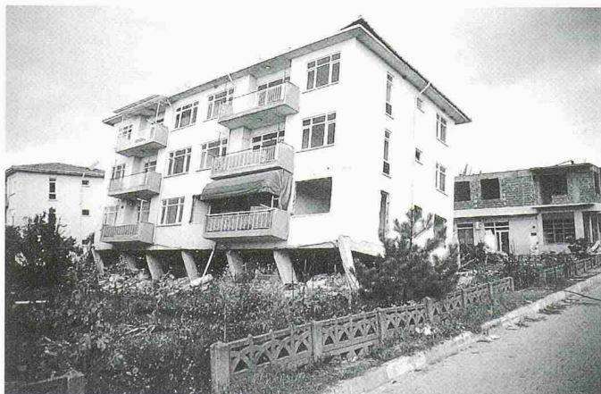
4 Totalschaden infolge zu schwach ausge- steiften Erdgeschosses («soft storey»- Schaden)
