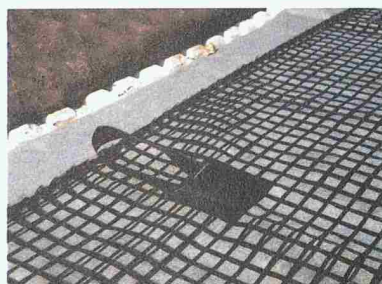
Auf Drainageschicht und Filtervlies wird das «Fallnet» flächig ausgebreitet. Die Kunststoffschlaufen dienen als Anschlagpunkte für das Sicherheitsgeschirr des Dachgärtners
