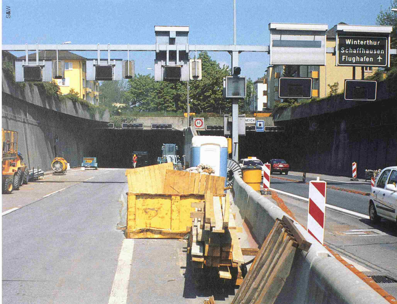
Sika-Produkte und ihre Verwendung bei der Instandsetzung durch die ARGE Tunnel Schöneich, Zürich
