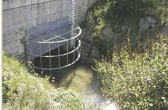
Ein Polder-System hält Hochwasser im Krauchthalbach zurück. Die Drosselung der Wassermenge erfolgt mittels Schieber. Der Rückstauraum bleibt landwirtschaftliche Nutzfläche (Bild: Karin Bovigny-Ackermann)
