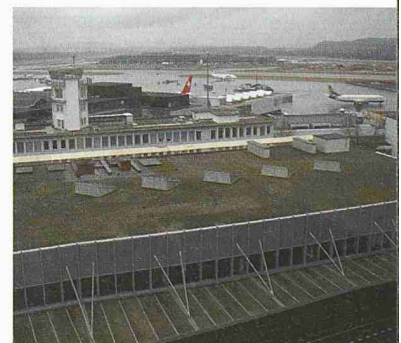
Blick auf das Vordach der heutigen Zufahrt am Flughafen Kloten (Bild: Unique, Flughafen Zürich AG)
