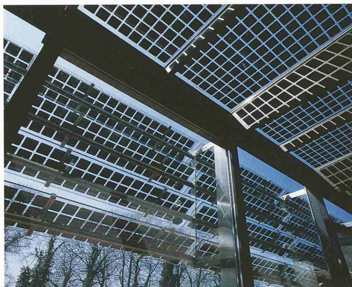
Kollektoren als Energiespender und Sonnenschutz an der Sporthalle der Kantonsschule Stadelhofen, Zürich (Bild: Reinhart Zimmermann)
