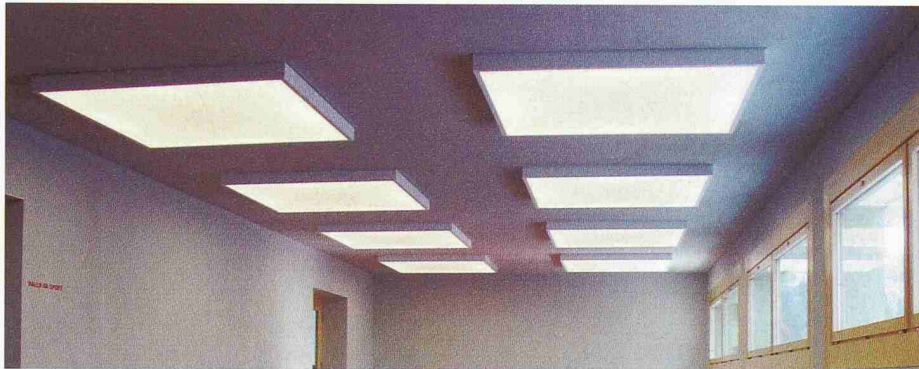
3 Foyer Center communal in Trun: Schaumstoffmatten wurden in die Leuchten integriert (2001, Architekt Joos Gredig + Peter Walser, Chur, Lichtplaner Fluora Leuchten, Herisau)
