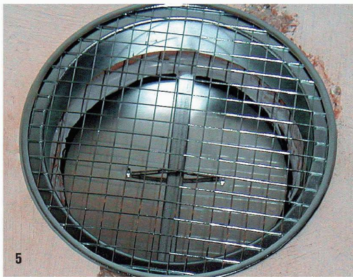
4 RWA-Klappe im Liftmaschinenraum in Druckhaltefunktion. Steuerung über Raumthermostat und Brandmeldeanlage 5 Geprüfte Druckklappe für Druckhaltung und Rückström- verhinderung
