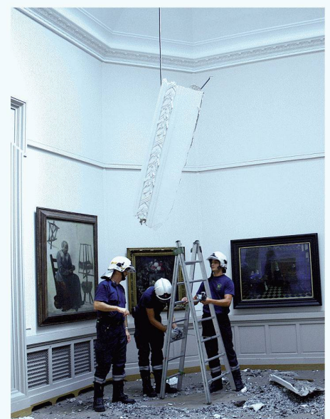
02 Durch das Herunterstürzen eines 7 m langen Deckenfrieses wird letztlich Nouvels Neu- und Umbauprojekt vorangetrieben (Bild: MAH Genf)
