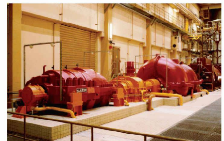
02 Der zweistufige Kompressor des Luftspeicher-Gasturbinen-Kraftwerks Huntorf. Im Hintergrund rechts schliessen Generator und Gasturbine an
