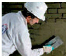
3. + 4. In die frische Haftbrücke wird der Remmers Dichtspachtel eingebracht. Egalisierung und Hohlkehle bis 50 mm Schichtdicke finden in einem Arbeitsgang statt.
