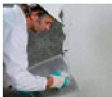
7. 13:00 Uhr: Ohne vorherigen Spritzbewurf kann als Oberflächenschutz der normal- oder schnellabbindende Remmers Sanierputz oder wahlweise auch die Remmers Schimmel-Sanierplatte aufgebracht werden.
