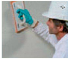
8. Der jeweilige Sanierputz wird mit dem Schwamm Brett abgerieben. Wenn die Oberfläche rapportiert werden soll ist eine Überarbeitung mit dem Remmers Feinputz notwendig.
