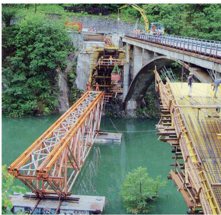
02 Das Lehrgerüst erlaubte einen Neubau neben der alten Brücke, unabhängig vom Pegelstand der gestauten Melezza (Bild: Dario Somaini, Grono)
