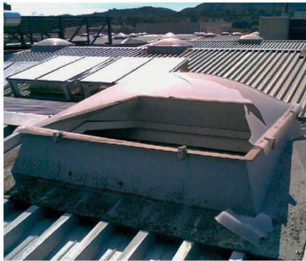
01 Oblicht (Lichtkuppel), durch das eine Person abgestürzt ist (Foto: Suva)
