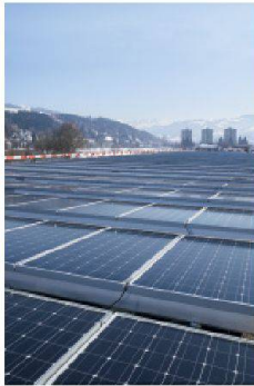
Fotovoltaikanlage auf dem Dach eines Fabrikgebäudes in Wattwil (SG). Mit einer Solarzellenfläche von 7163 m 2 ist es eine der grössten Anlagen in der Ostschweiz (Foto: Hannes Henz)
