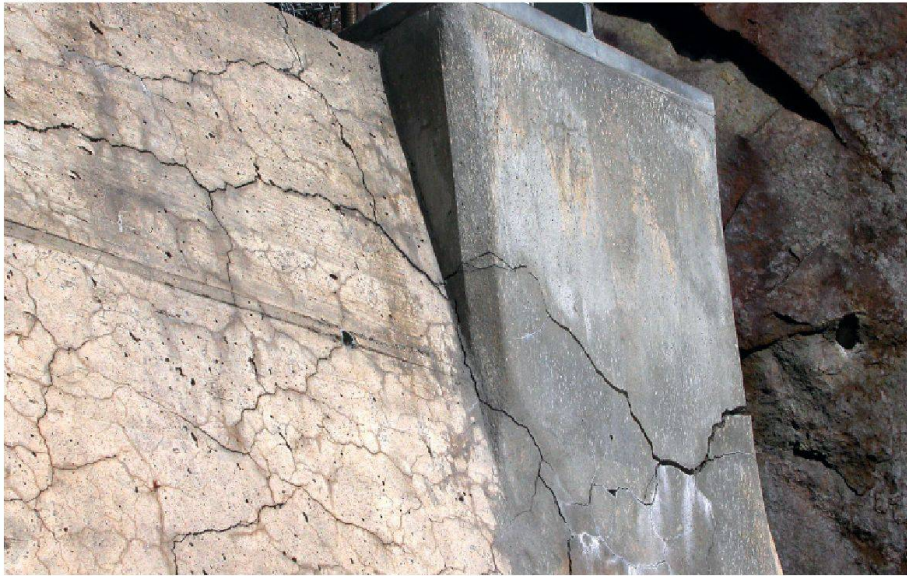
01 Typische Betonschäden infolge Alkali-Aggregat-Reaktion mit Rissöffnungen im Millimeter- bis Zentimeterbereich. (Foto: Christine Merz)
