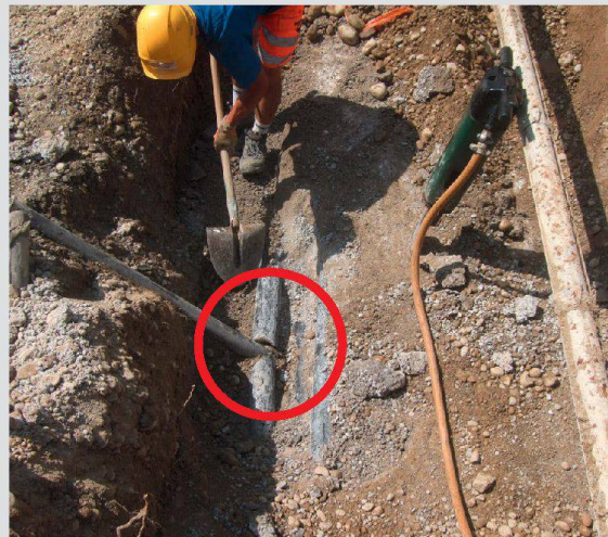
In Frauenfeld wurde bei Tiefbauarbeiten im August 2012 ein Rohrblock von Swisscom durchbohrt. Die Reparaturarbeiten dauerten mehr als fünf Tage.
