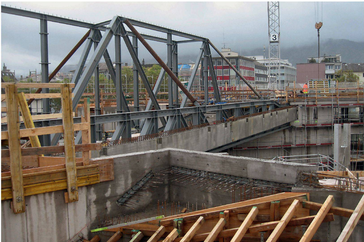
Baustelleneindruck: Links die ein- und dreigeschossigen Fachwerkträger der «Wohnbrücke» über der Tramhallenausfahrt. Parallel dazu der erste vorfabrizierte Betonhauptträger des Tramhallendachs mit den Aussparungen für die Sekundärträger. Rechts die Mittelstütze des folgenden Hauptträgers. Im Vordergrund die Schalung für die faltwerkartige Freitreppe zum Innenhof.
