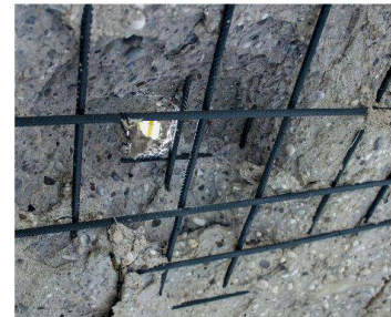
Explosives Abplatzen infolge Brand an einer 16 cm starken Holz-Beton-Decke.
