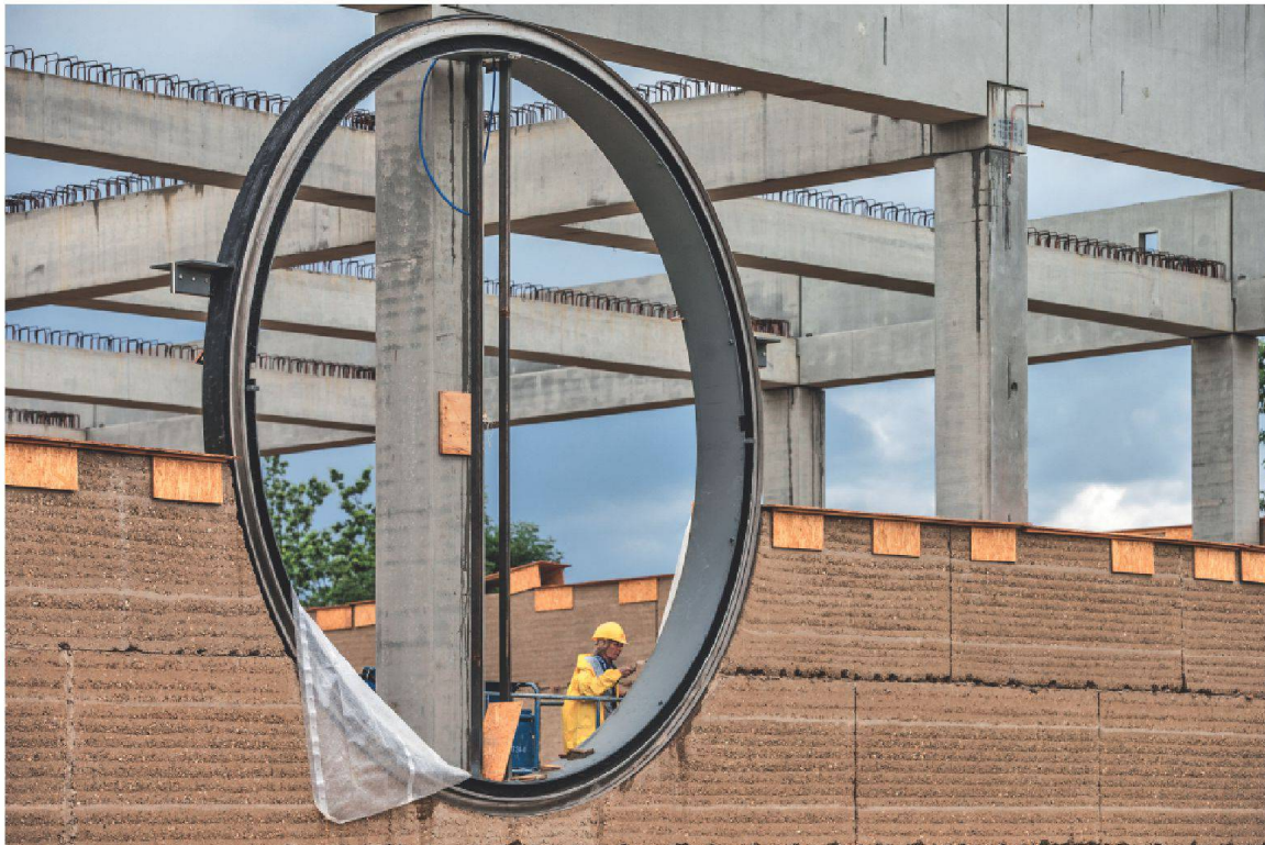
Das Kräuterzentrum von Ricola in Laufen – wie es in den Medien praktisch nie zu sehen ist: Der Lehm aufgestapelt in einzelnen vorgefertigten Blöcken, dazwischen der runde Stahlrahmen für das Fenster mit den beidseits angeordneten Stahllaschen und dahinter das Betonskelett, das das ganze Bauwerk stabilisiert und trägt.
