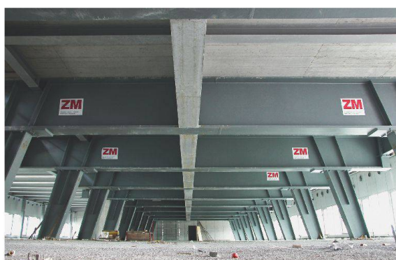
Abfangtisch: Das Raster von 5 \times 12.5 m im bestehenden Trockenwerk ist für den Wohnungsbau, der oben aufgestockt wurde, nicht optimal. Ein Zwischengeschoss mit einem Trägerrost aus Stahl bildet den Wechsel (vgl. Schnitt oben).
