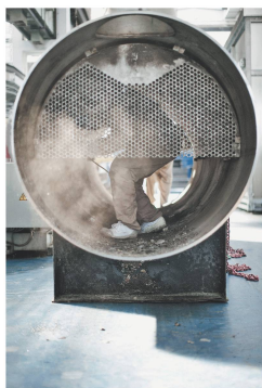
Jahrzehntelanges Arbeiten im Sperrbezirk: Trennarbeiten im Kühler des Kernkraftwerks Lubmin bei Greifswald.
