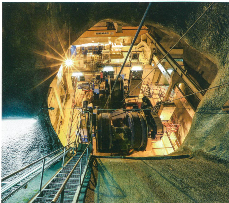
Arbeiten am Gotthard-Basistunnel: Blick in den Schrägschacht, der die Windenkammer mit der Schachtglocke verbindet.
