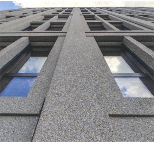
Ganz oben: Kunstvoll verstärkt und lobend erwähnt: die Sanierung des Westtrakts der Schulanlage Feldli. Oben: Robust verankert und lobend erwähnt: der Neubau LEE der ETH Zürich.
