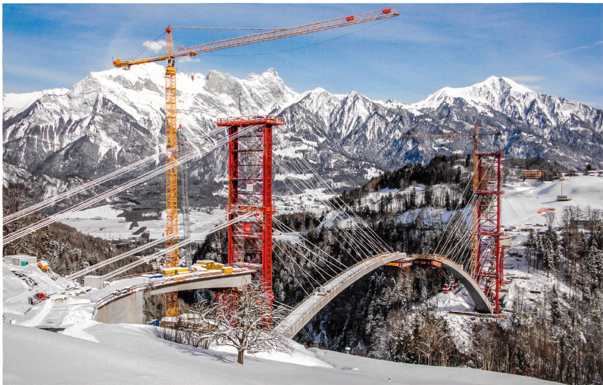
Musterbeispiel eines Freivorbauverfahrens : Bis zum Bogenschluss trug das Hilfsgerüst die auskragenden Bogenhälften.
