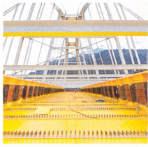
Die Stahlkonstruktion der neuen Eisenbahnbrücke Massongex vor dem Betonieren des Fahrbahntrogs. Coverfoto von Hartmut Mühlberg.
