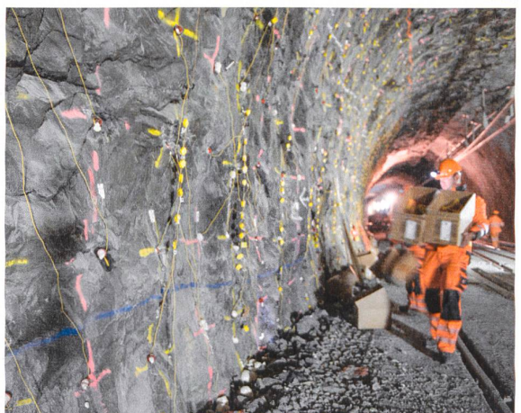
Vor der Sprengung: 1492 Sprenglöcher, verteilt auf 76 m Länge, eine Detonation ergeben nach 3.3 Sekunden ...
