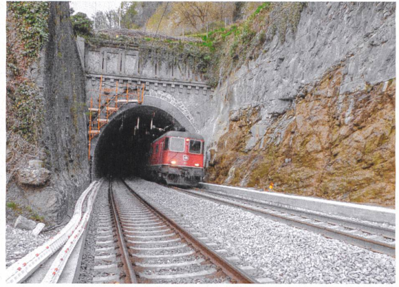
Nördliches Tunnelportal auf Bexer Seite nach Fertigstellung mit den darüber liegenden Schiesscharten der Befestigungsanlage Dufour .
