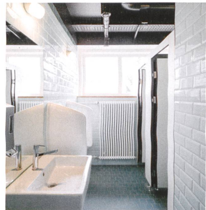
Durch den Verzicht auf eine abgehängte Decke konnten die grossen Fenster in den WCs erhalten werden. Die facettierte Keramik erinnert an die 1930er-Jahre.
