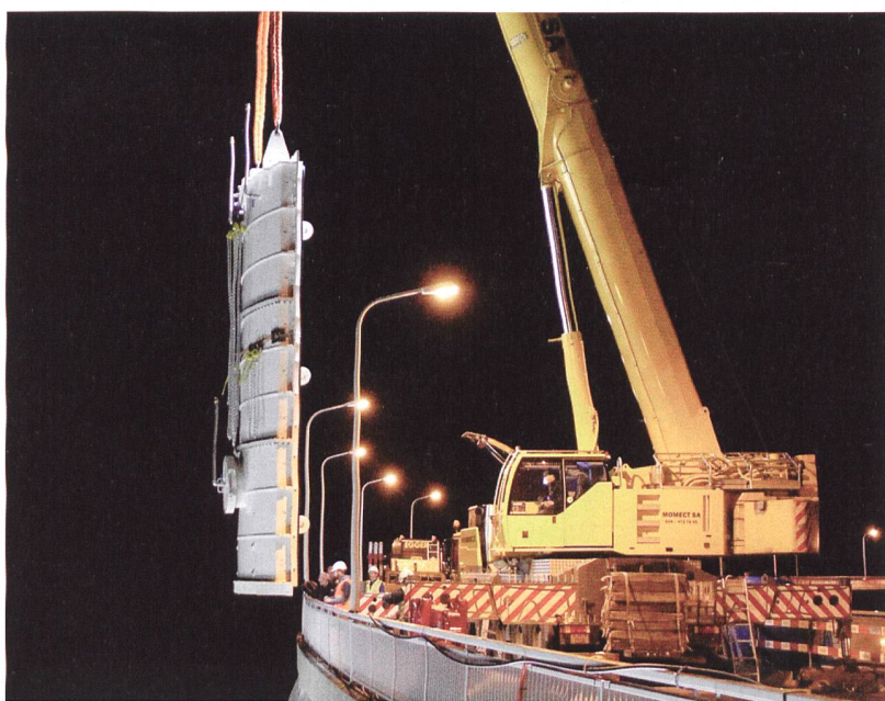
Der Abschluss für den Grundablass wird für die spätere Montage an der Staumauer vor dem Einlauf positioniert.
