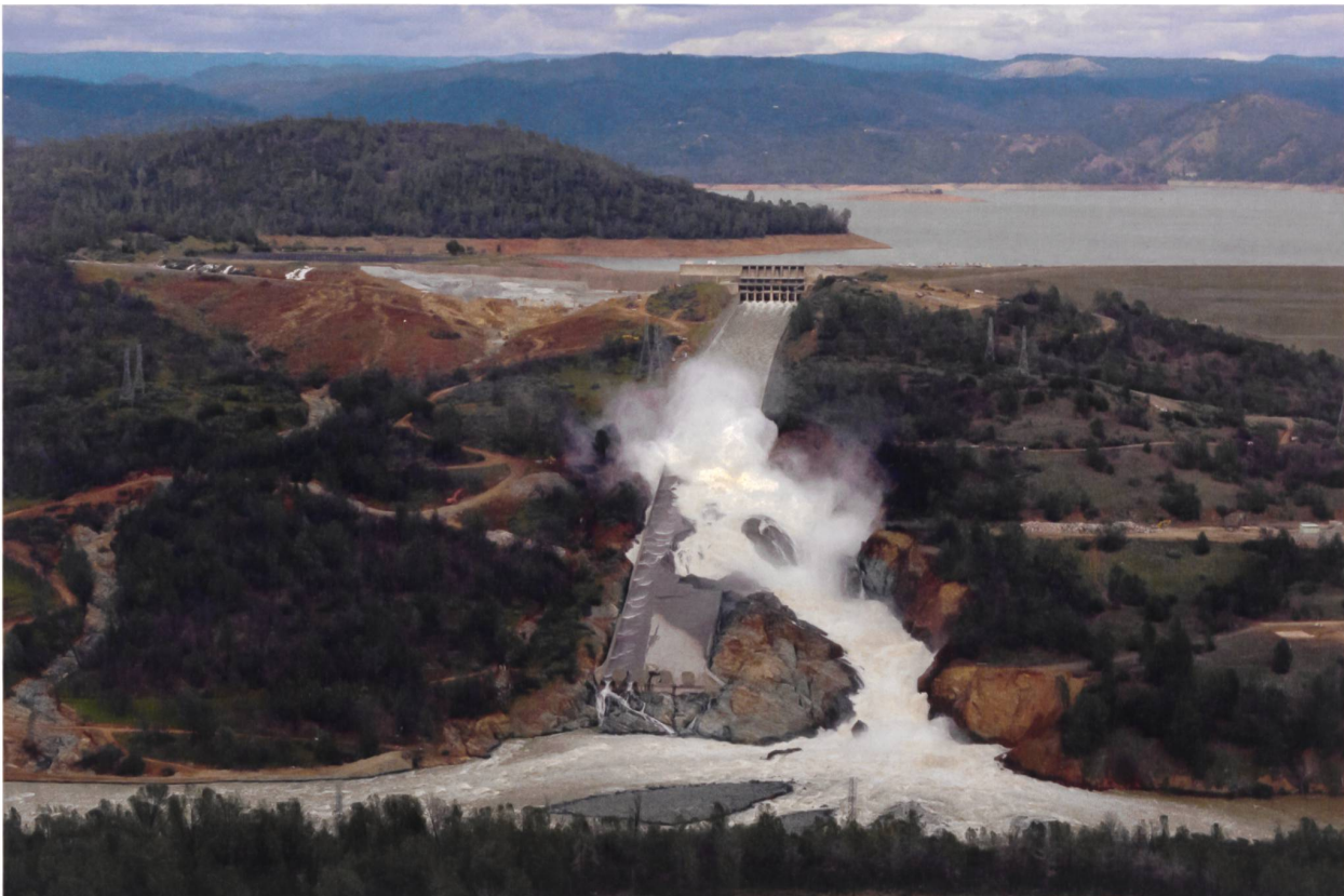
Luftansicht des Lake Oroville , 26. Februar 2017: Oben links ist derjenige Teil des Damms erkennbar, der als Überlauf ausgebildet ist, der Hang darunter ist teilweise stark erodiert. In der Bildmitte die Hochwasser-Notentlastung mit beschädigter Schussrinne .
