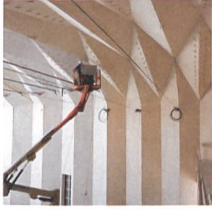
Im Innenraum des Théâtre de Vidy bei Lausanne werden die letzten Arbeiten ausgeführt. Coverfoto von Christopher Robeller .
