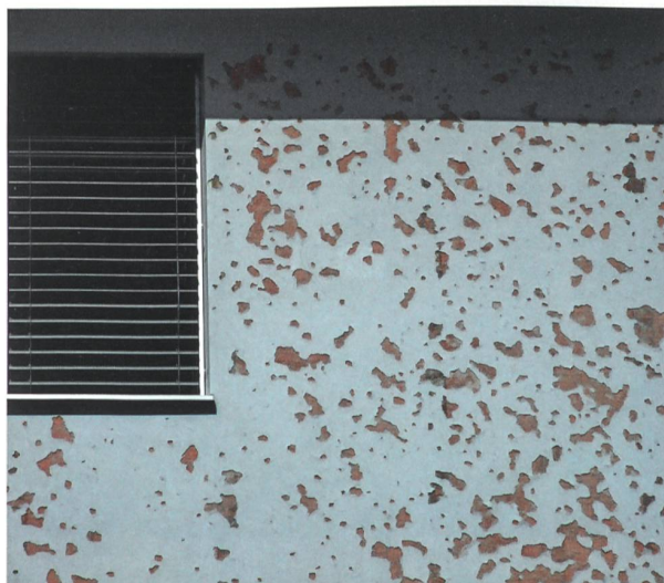
Hagelschäden am Verputz einer Fassade.
