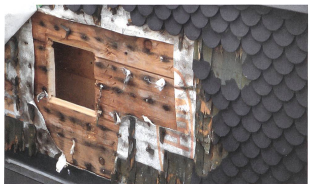
Ein zu dichter Farbanstrich auf den Holzschindeln wirkt als Diffusionssperre. Hinter den Holzschindeln staut sich Wasserdampf an und führt zum Faulen des Holzes.
