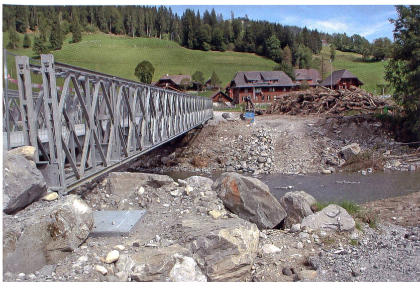
Die Notbrücke in Bumbach nach der Hochwasserkatastrophe vom 24.07.2014.
