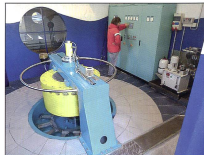
Abb. 3: Generator eines Kleinwasserkraftwerks.
