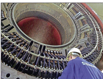
Abb. 4: Generator der Firma Siemens.
