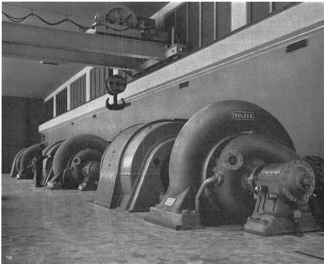
3 umkehrbare Sulzer-Pumpen-Turbinen in der Zentrale Stafel der Grande Dixence S.A. Leistungsaufnahme als Pumpe 10470 PS, Leistungsabgabe als Turbine 11100 PS
