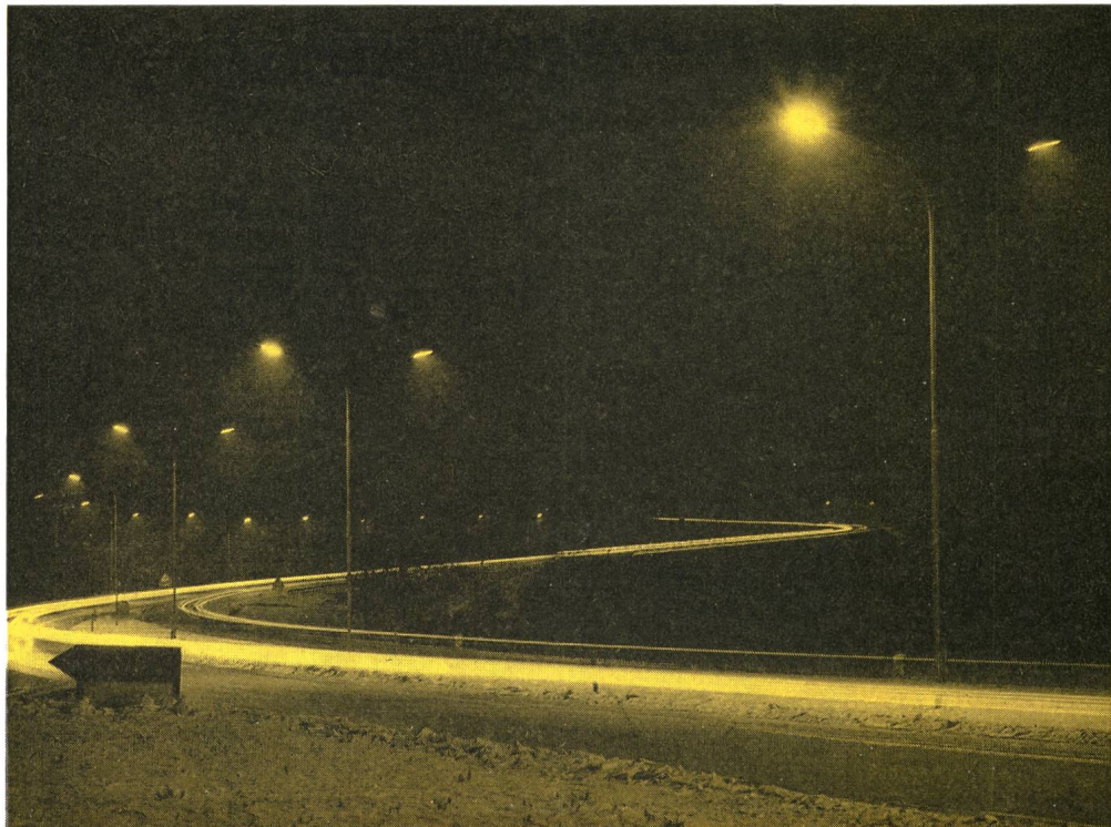
Fig. 18 Beleuchtung einer Kreuzung der Autostrasse Winterthur-Schaffhausen
