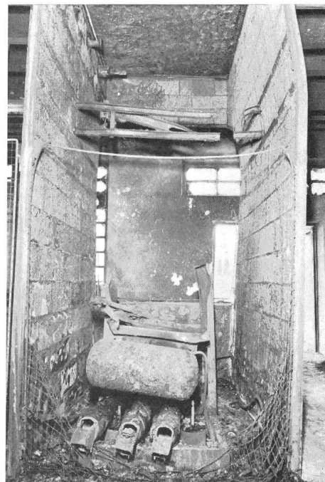
Fig. 5 Zerstörte Transformatorzelle 10 kV-Schalter
