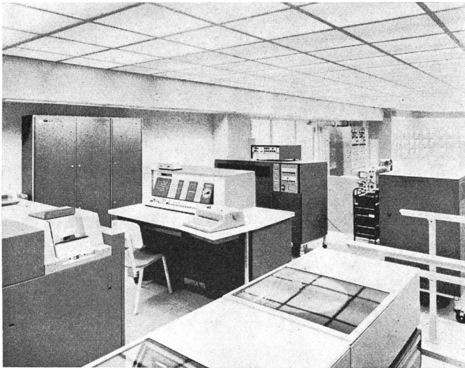
Fig. 8 Plattenspeicher und der Steuercomputer im Lastverteilerzentrum Canton der AEP
