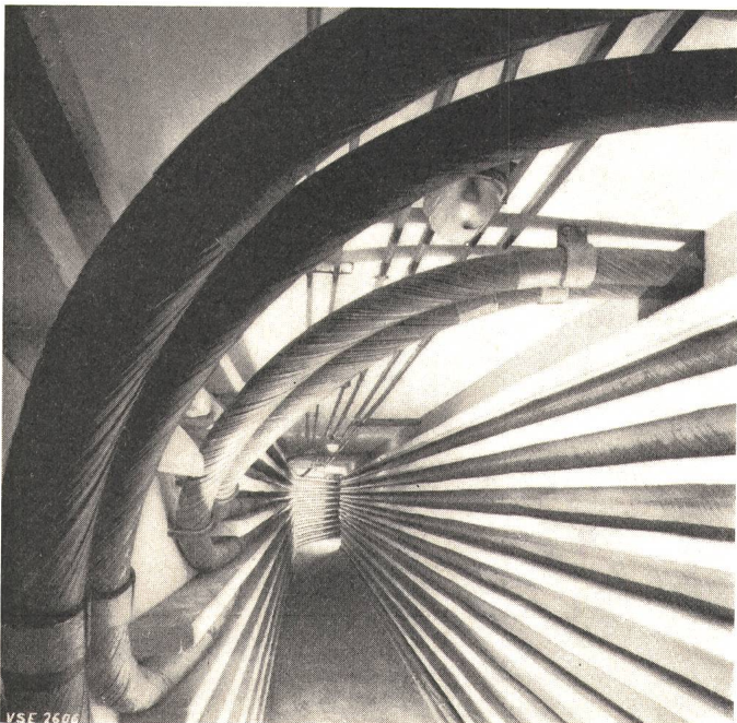
Fig. 8 Kabelanordnung in einem begehbaren Kabelkanal
