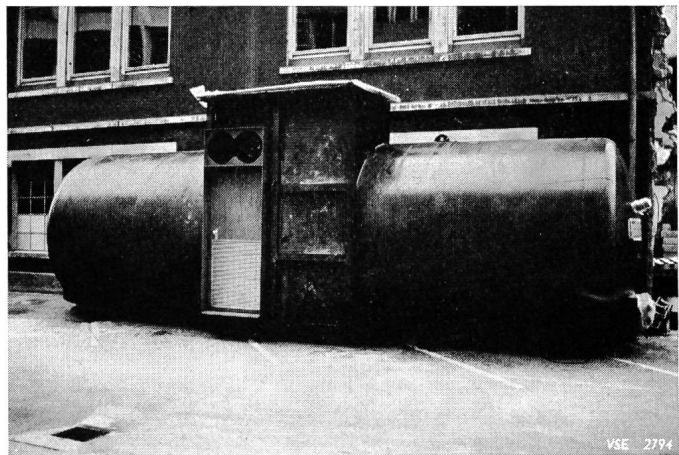
Fig. 7 Neue Zisternenkabine für 2 MVA (Gewicht ohne Trafo: 12 t mit Ausrüstung)
