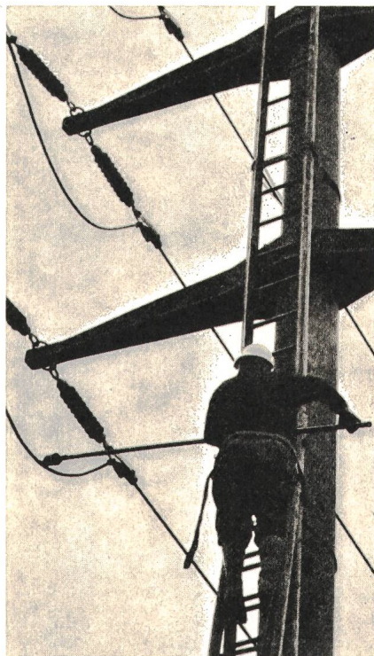
Peyer-Optictest in 50/150 kV Hochspannungsfreileitung
