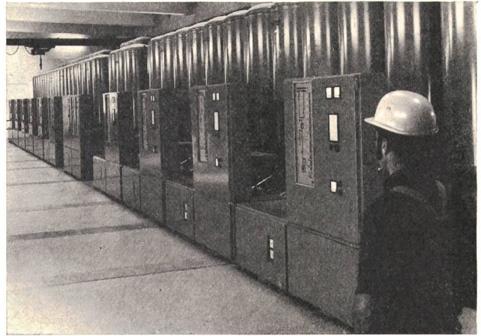
Fig. 3 SF 6 -isolierte Schaltanlage
