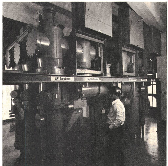
Fig. 5 Station mit fünf Lasttrennschaltern
