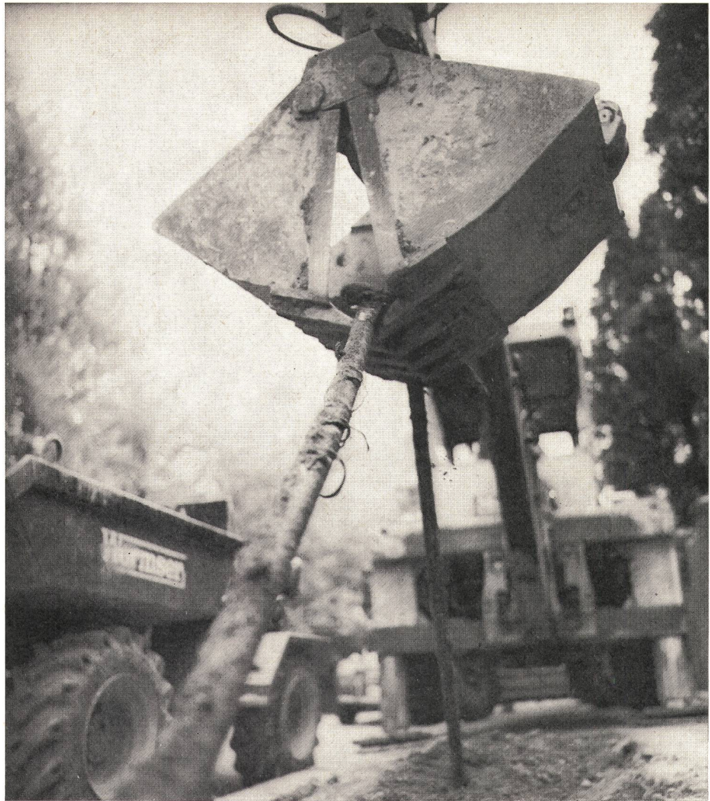
Unvorsichtigkeit bei Grabarbeiten kann böse Folgen haben (in der Schweiz werden täglich rund 30 Leitungen beschädigt)
