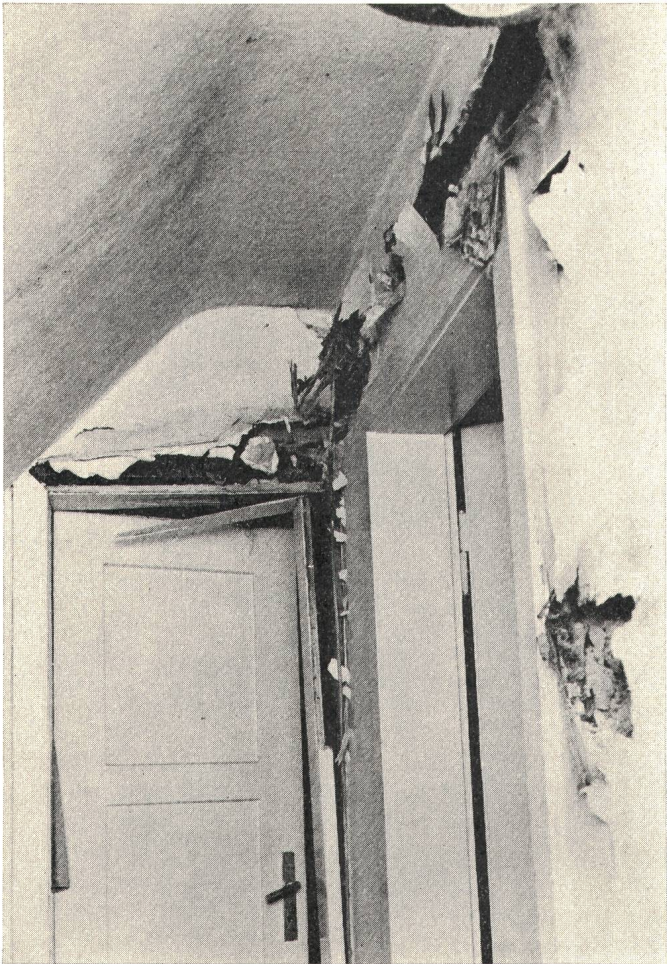
Fig. 9 Installationsleitungen wurden vom Blitzstrom verformt und aus der Wand gerissen (Zu dünne Drähte können verdampfen)
