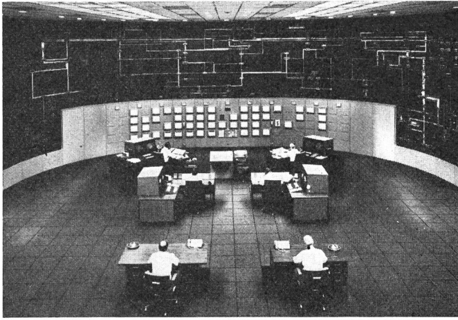
Fig. 10 Führungszentrum New York Power Pool, Albany
