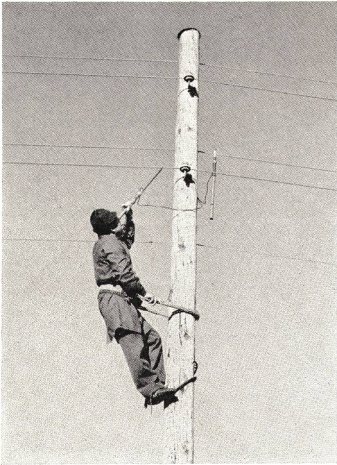
Fig. 12 Durchführung der Prüfung auf Spannungsfreiheit in Mast- oder Dachständer-Ortsnetzen (380/220 V) durch den Ortsmonteur
