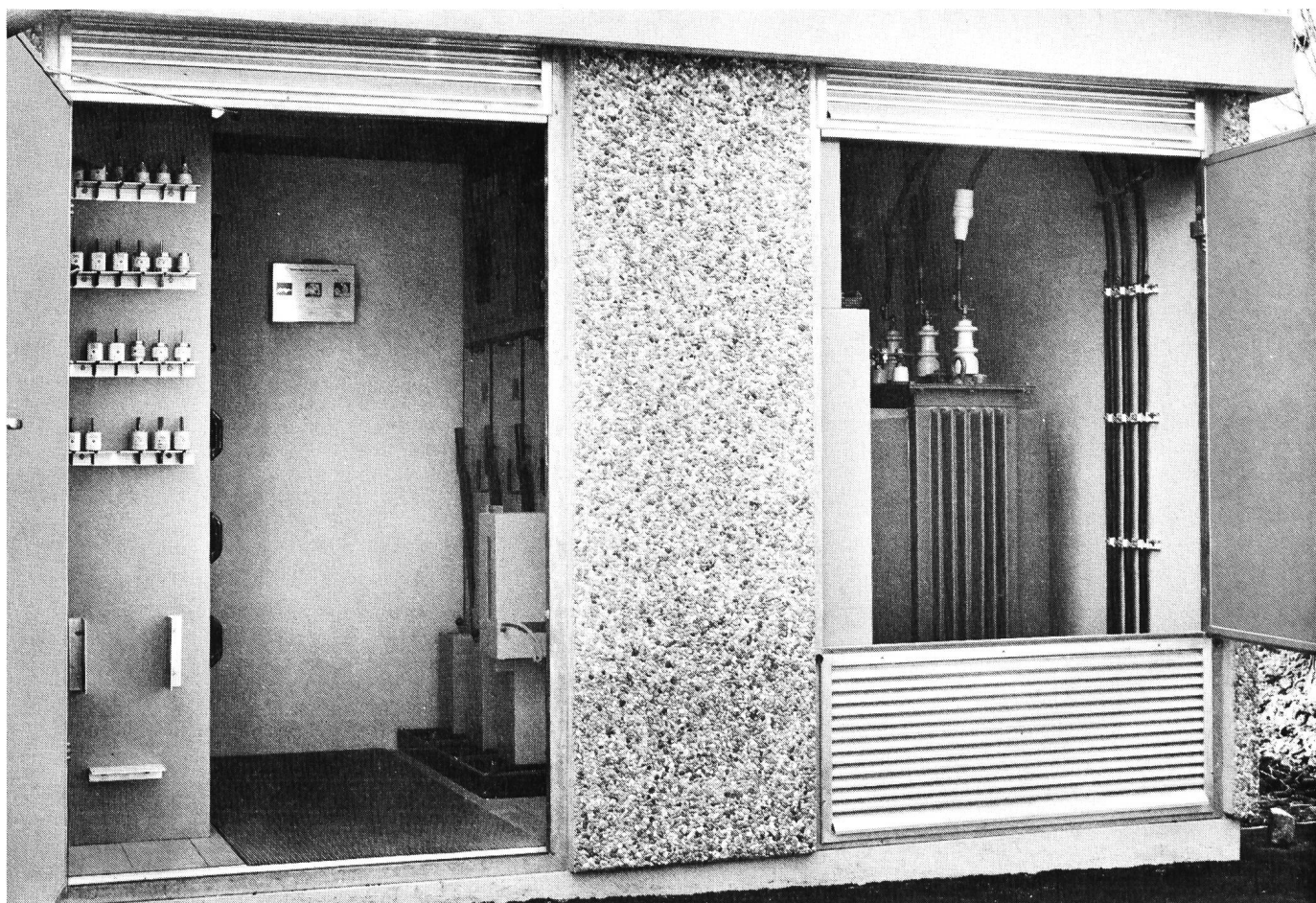
Fabrikfertige, typengeprüfte Kompaktschaltanlage Typ RGB 24 mit ausfahrbaren dreipoligen Lastschaltern 400 A, 24 kV
