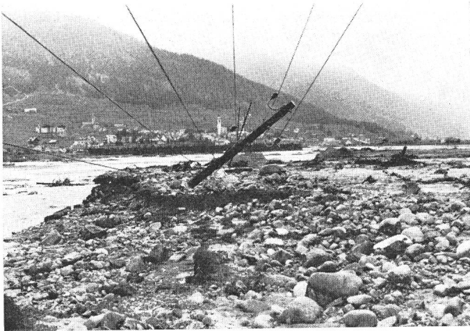
Fig. 4 Überschwemmung der Ebene bei Samedan durch Inn und Flazbach 1954 Umgerissene Talversorgungsleitung 16 kV
