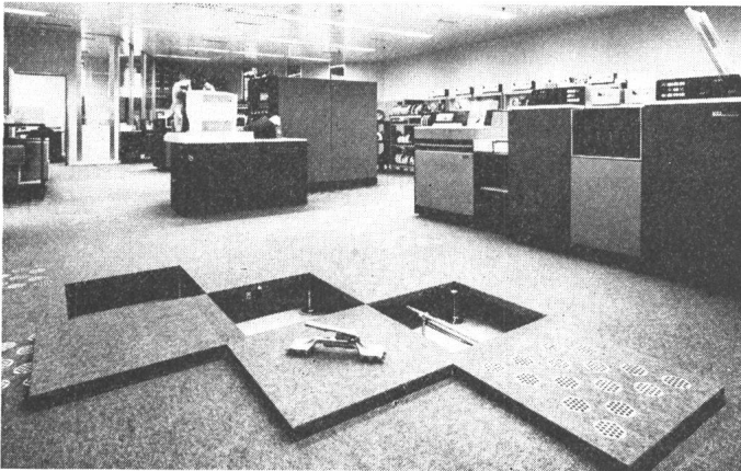
In Doppelböden verlegte Versorgungs- und Informationsleitungen
